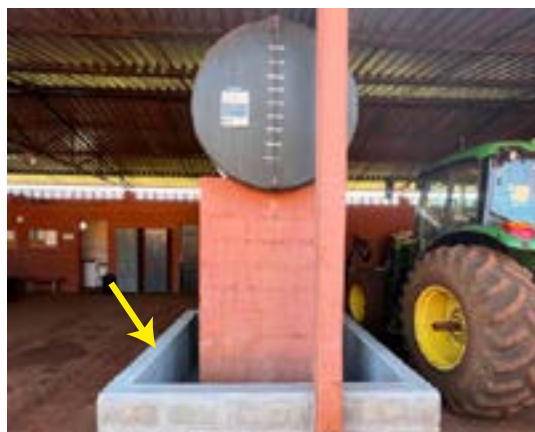
Seta amarela indica barreira de contenção
